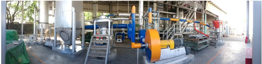
圖 1 280kW 準工業級燃燒試驗系統平台
